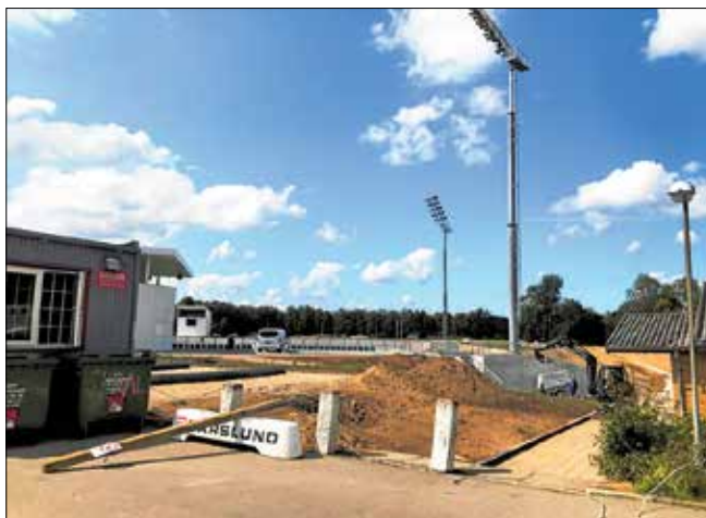
Noget gik åbenbart galt her under byggeriet af den jordvold, der er en af stadionets hovedelementer. Nu er der simpelthen sammenstyrtningsfare. Billedet er taget under byggeriet. Foto: Andreas Norrie
